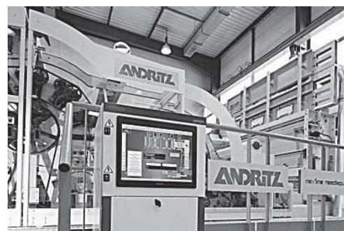
Slika 12: Kontrolni sistem Andritz Scada za optimizacijo in nadzor proizvodne linije [8]
